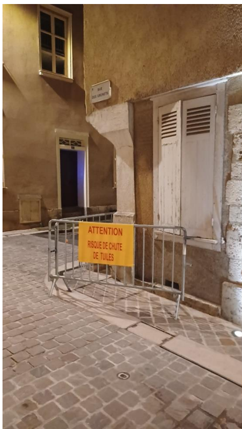
Photo datant de fin 2022 avec les mises en sécurité installée par la Ville de Chartres devant la maison du 9 rue des Grenets.
