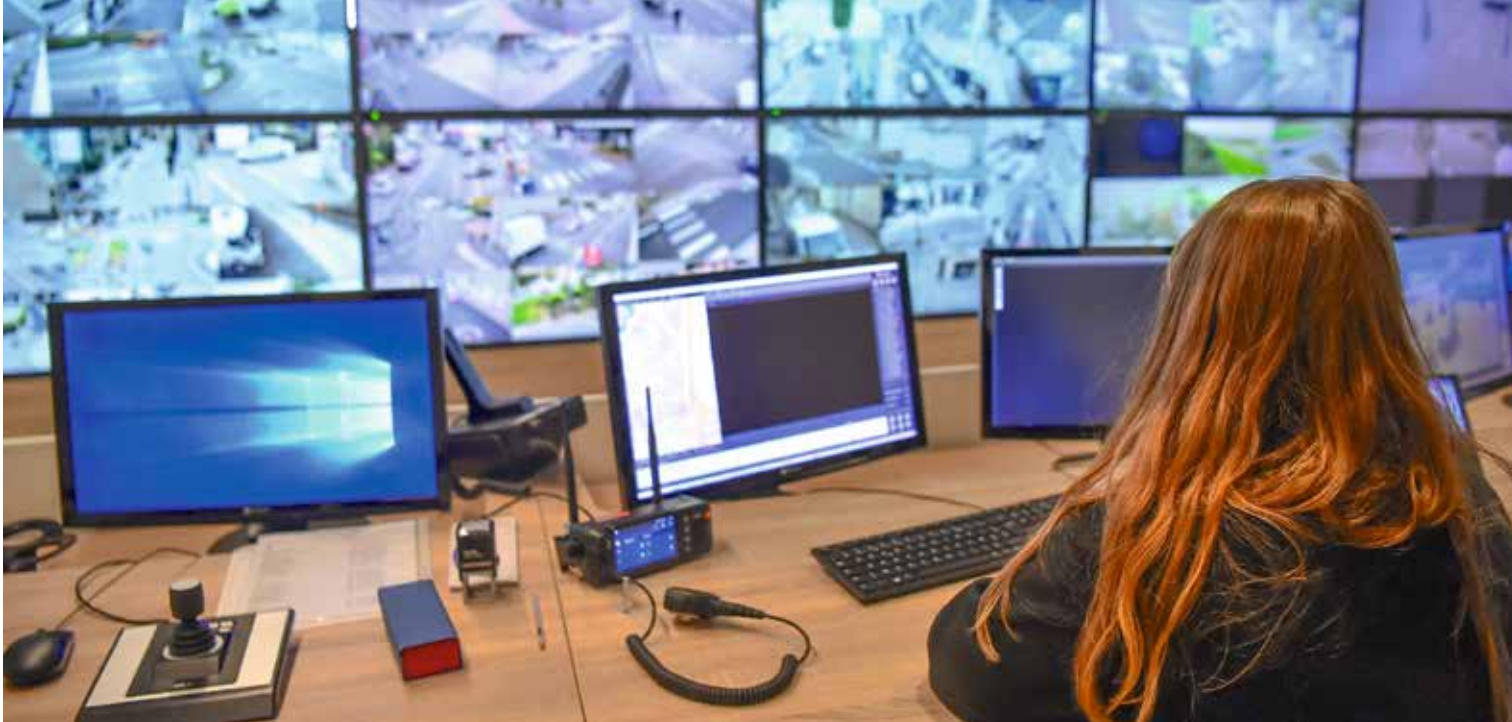
Les écrans du Centre de supervision intercommunal.
