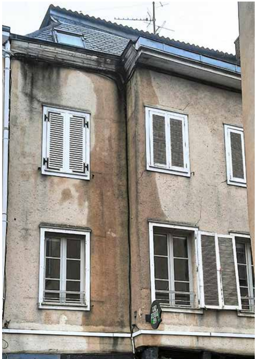
Exemple d'infiltration d'eau dans un bâtiment ancien, au 16, rue de la Pie.
