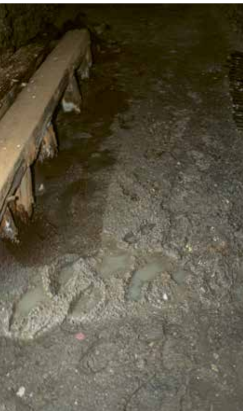
Facteur aggravant : les détériorations de canalisation d'eau.
