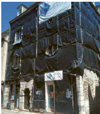
Bâtiment en cours de rénovation. Structure de façade dégradée par des infiltrations, niveau de cave altéré... de nombreux bâtiments sont aujourd'hui l'objet d'importants travaux de restaurations. Les dispositifs d'aide sont de bons appuis.
